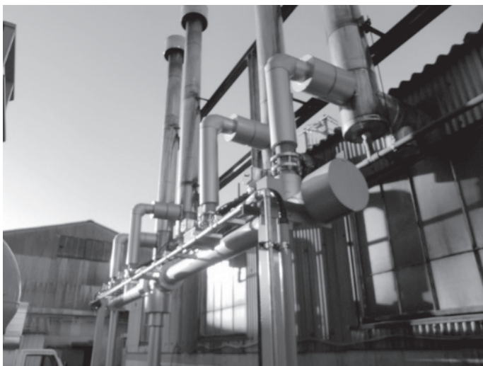
図4 ボイラーの燃焼排ガスの排出煙突
